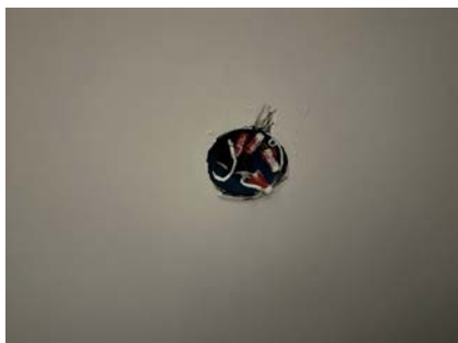
Manglende lokk på koblingsboks.
