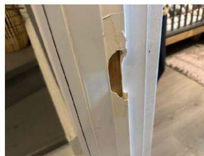
Skade i dørkarm til soverom.
