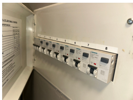
Sikringsskap med automatsikringer.
