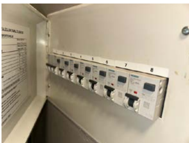
Sikringsskap med automatsikringer.
