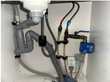
Røropplegg i kjøkkenbenk
