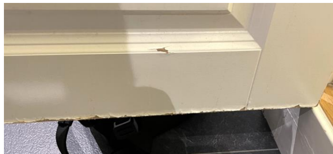
Malingsslitasje i nedre del av badedør
