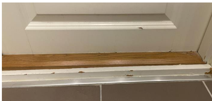
Ingen tilluft ved dør
