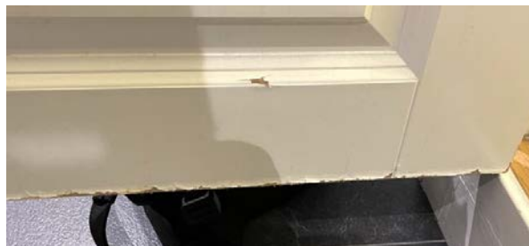
Malingsslitasje i nedre del av badedør
