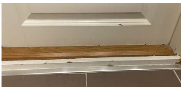
Ingen tilluft ved dør
