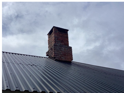
Pipe anbefales helbeslått over tak.
