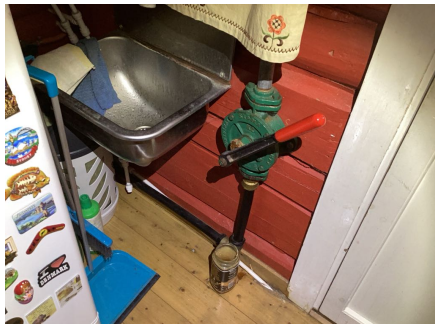
Manuell pumpe som tar vann fra brønnen, denne brukes kun til oppvask.
