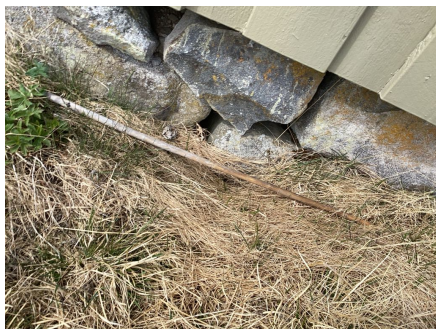
Åpninger i grunnmur som gjør at mus enklere kan ta seg inn i boligen.
