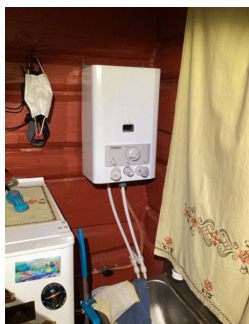
Propanvarmer går kun til oppvaskkum på kjøkken.
