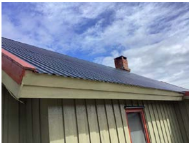
Ikke montert takrenne på deler av hytta.
