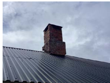
Pipe anbefales helbeslått over tak.
