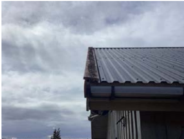
Det er ikke montert toppbordbesalg, dette anbefales.
