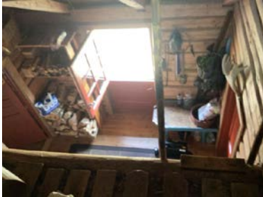
Ingen sikring fra loft/hems.
