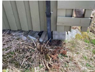
Nedløp mangler utkast.
