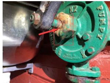
Liten drypplekkasje fra pumpe ved bruk.
