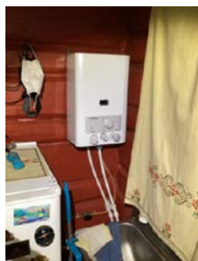
Propanvarmer går kun til oppvaskkum på kjøkken.
