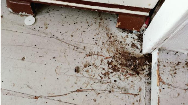
Det er stedvis påvist synlige skader på overflater.
