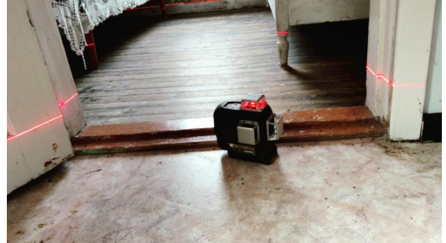
Målt høydeforskjell på over 30 mm gjennom hele rommet. Tilstandsgrad 3 gis med bakgrunn i standardens krav til godkjente måleavvik.
