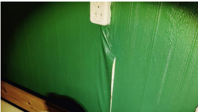
Det er stedvis påvist synlige skader på overflater.
