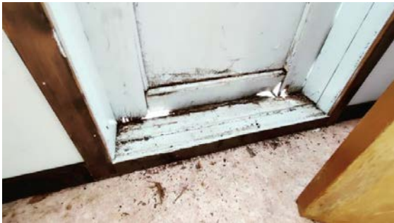
Dører har råteskader.
