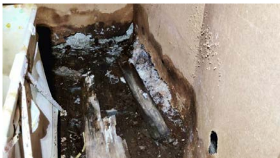
Det er registrert omfattende synlige fuktskader
