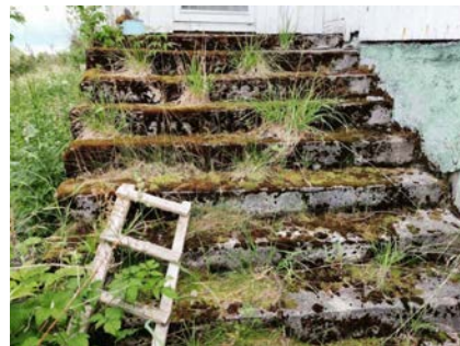
Manglende rekkverk trapp.
