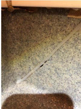
Bilde av glippe/sprekk i skjøten på belegget
