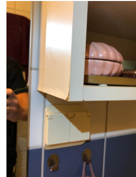
Bilde av svelling på innredning
