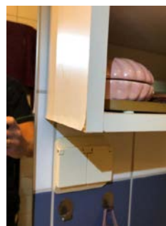
Bilde av svelling på innredning
