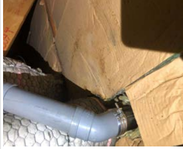
Fuktskjolder på isolasjon. Antatt fra kondens
