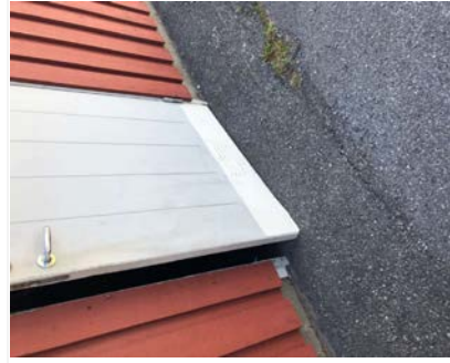
Dør som subber mot terreng
