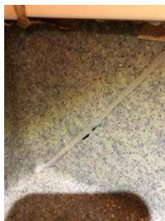
Bilde av glippe/sprekk i skjøten på belegget
