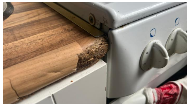
Eksempel på skade på kjøkkeninnredningen
