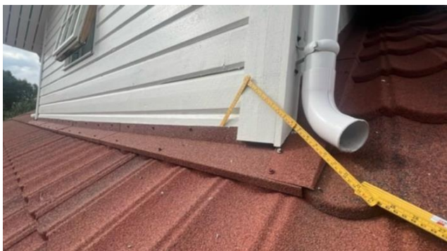
Eksempel på feil beslagsløsning.
