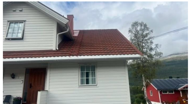
Eksempel på manglende snøfangere.
