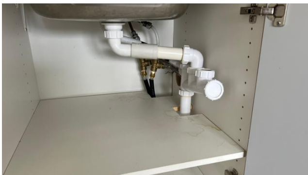
Fuktskjolder i benkeskapet
