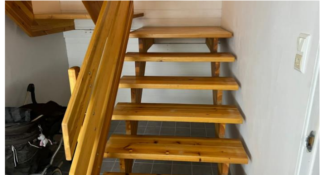
Trapper har avvik med håndløpere og åpninger mellom trinn og i rekkverket.
