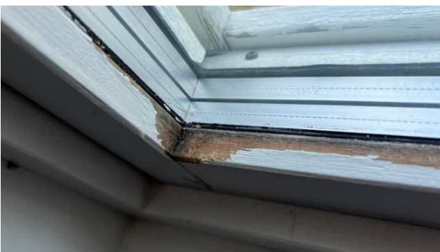
Fuktmerker i vinduskarm
