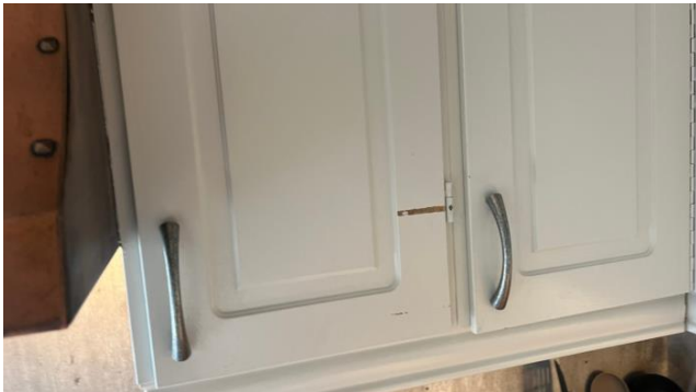
Eksempel på slitasje
