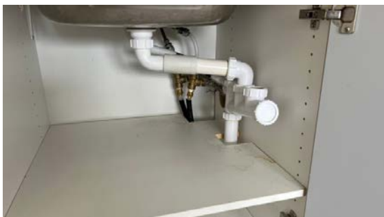
Fuktskjolder i benkeskapet
