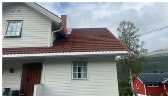
Eksempel på manglende snøfangere.
