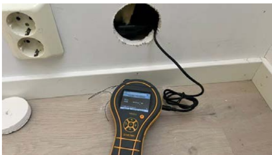
Fuktmåling inn mot dusjnisjen
