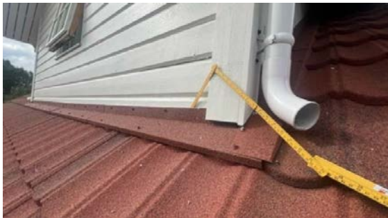
Eksempel på feil beslagsløsning.
