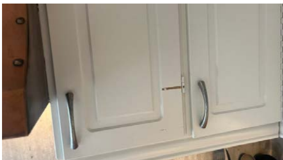
Eksempel på slitasje
