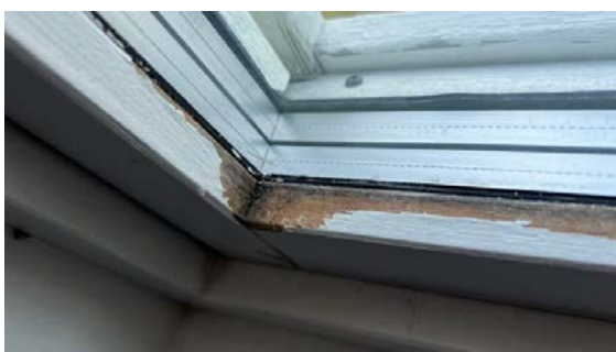
Fuktmerker i vinduskarm
