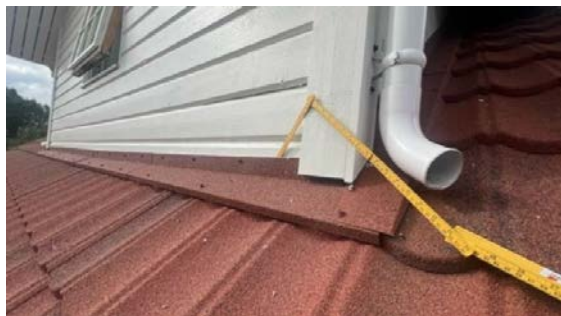
Eksempel på feil beslagsløsning.
