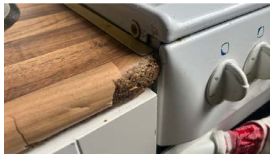
Eksempel på skade på kjøkkeninnredningen
