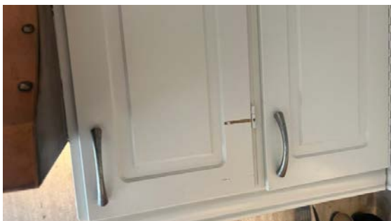
Eksempel på slitasje
