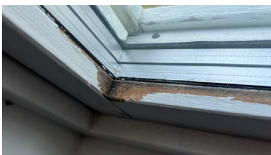
Fuktmerker i vinduskarm
