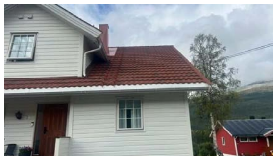
Eksempel på manglende snøfangere.
