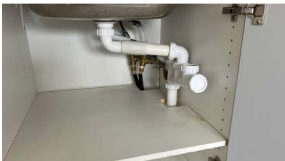
Fuktskjolder i benkeskapet
