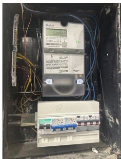
Sikringsskap med automatsikringer.
