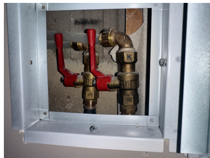
Stoppekran plassert i luke på soverom
