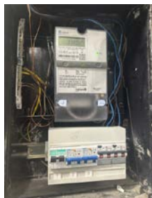
Sikringsskap med automatsikringer.
