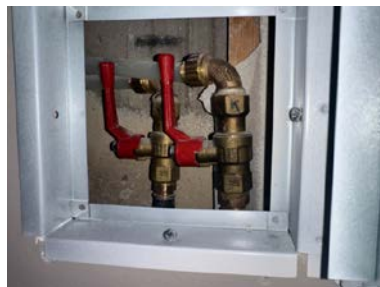
Stoppekran plassert i luke på soverom
