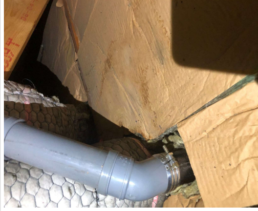
Fuktskjolder på isolasjon. Antatt fra kondens
