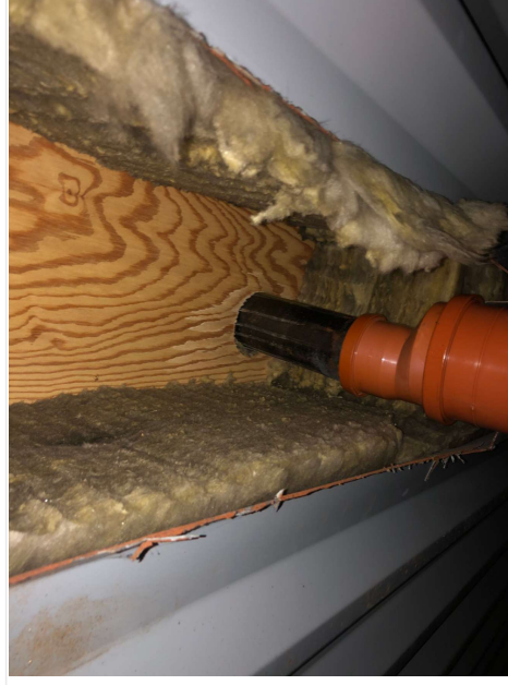
Bilde av manglende isolasjon rundt avløpsrør i krypkjeller
