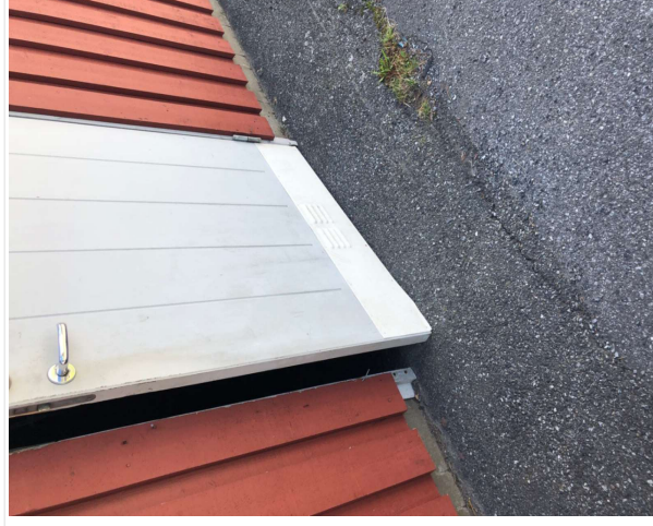
Dør som subber mot terreng
