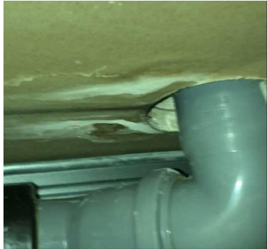
Bilde av avløpsrøret til vaskemaskin
