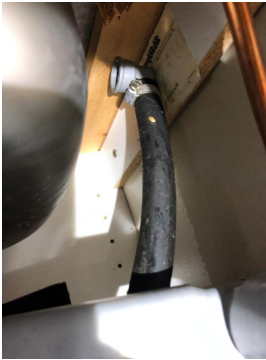
Bilde av løs slange fra sikkerhetsventil
