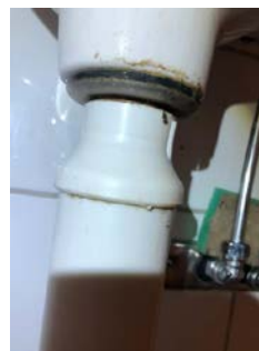
Bilde av lekkasje fra servantavløp
