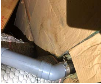
Fuktskjolder på isolasjon. Antatt fra kondens
