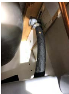
Bilde av løs slange fra sikkerhetsventil
