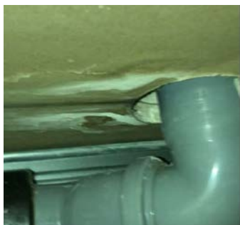
Bilde av avløpsrøret til vaskemaskin
