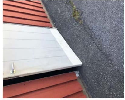
Dør som subber mot terreng
