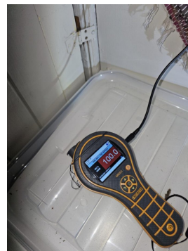
Noe fukt i himling/undertak ved pipe
