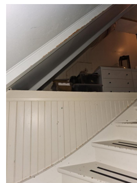
Trapp til loft mangler rekkverk
