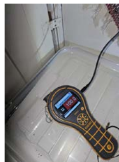
Noe fukt i himling/undertak ved pipe
