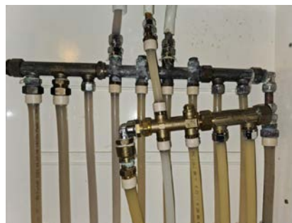
Fordelerskap for rør-i-rør
