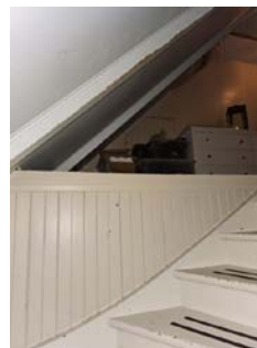
Trapp til loft mangler rekkverk
