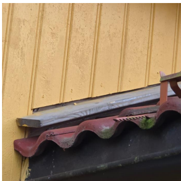
Mangler beslag mellom vegg og tak tilbygg
