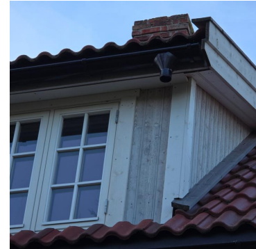
Mangler beslag mellom vegg og tak tak oppløft og noe manglete nedløp og utkast
