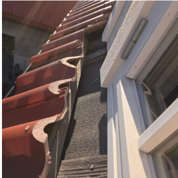
Manglete beslag og avslutting på takteking
