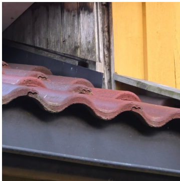
Manglete beslag og avslutting på takteking
