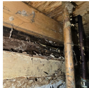
Råte i bjelke under kjøkken.
