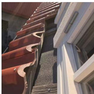
Manglete beslag og avslutning på taktekking
