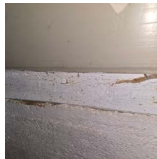
Hul svil/bjelke i trappenedgangen
