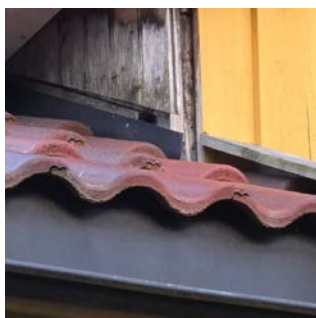
Manglete beslag og avslutning på taktekking
