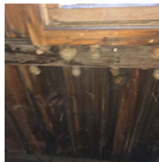
Fukt merker og vepsebord.
