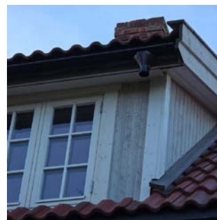
Megler beslag mellom vegg og tak tak oppløft og noe manglete nedløp og utkast
