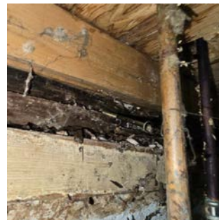
Råte i bjelke under kjøkken.
