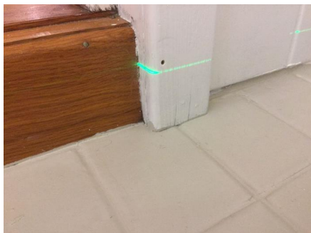
Fuktopptrekk i omramning til dør.
