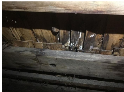
Råteskade på undertak. Denne er trolig gammel og var tørr ved befaring.
