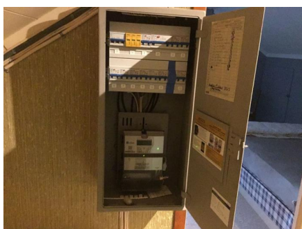
Sikringsskap plassert i loftsetasje.
