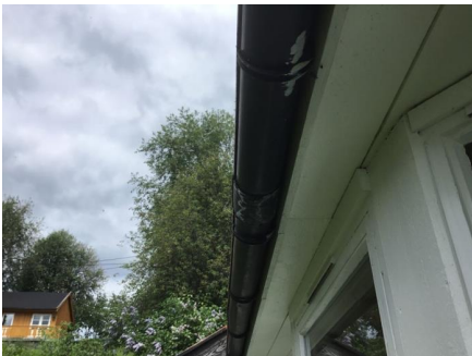
Lekkasje på takrenne.
