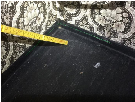
Gulvbelegg har løsnet fra underlag i hjørne.
