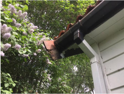
Vindskier har råteskader.
