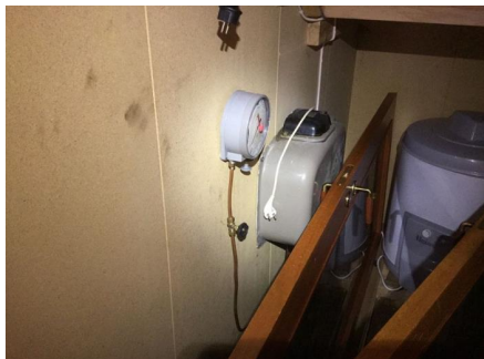
Oljeløfter plassert på bod under trapp.
