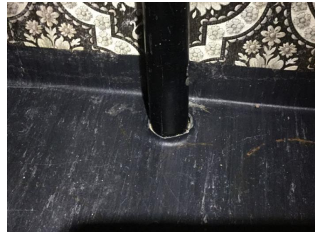
Utettheter rundt rørføringer.
