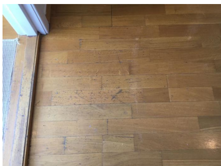
Slitasje på overflater.
