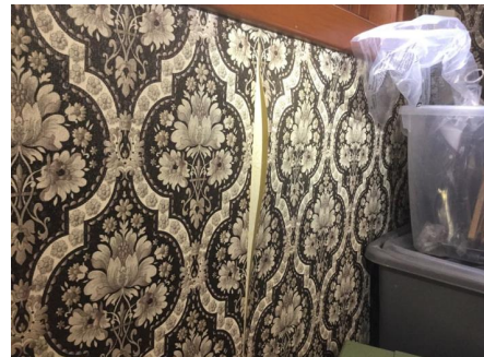
Tapet har løsnet fra underlag.
