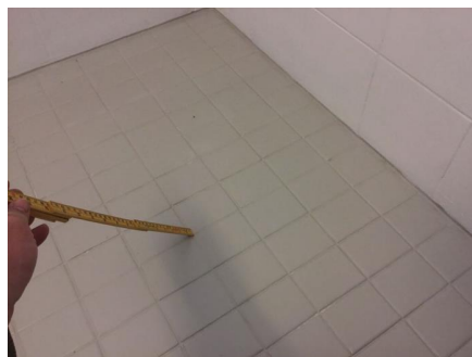
Bom på fliser ved servant.
