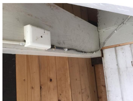
Eldre strømkabler er koblet sammen med nyere anlegg. Ledning mellom koblingspunkt bør byttes.
