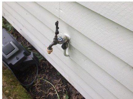
Utekran i dårlig stand.
