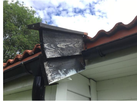
Takrenne mangler endelukk.
