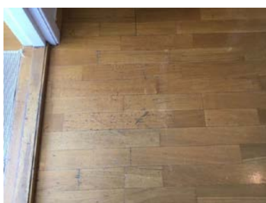
Slitasje på overflater.
