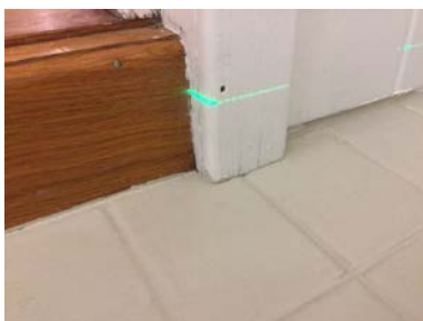
Fuktopptrekk i omramning til dør.
