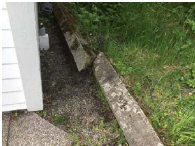
Større sprekker og skjevheter på støttemur.
