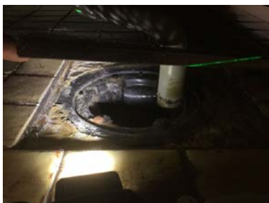
Kontroll av sluk. Ingen synlig slukmansjett i sluk.
