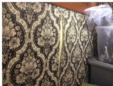
Tapet har løsnet fra underlag.
