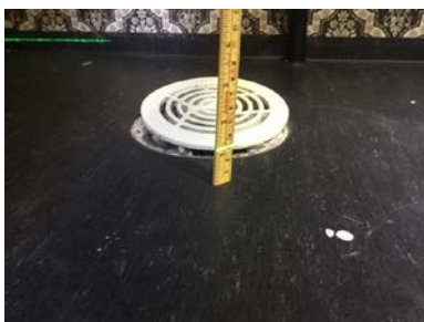
Motfall mot dør er registrert.
