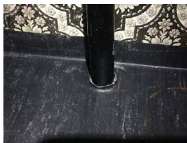
Utettheter rundt rørføringer.
