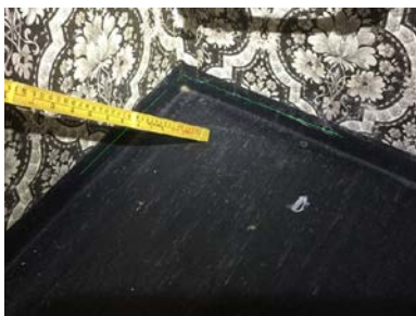
Gulvbelegg har løsnet fra underlag i hjørne.
