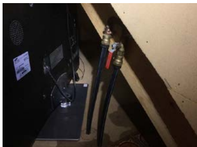
Stoppekran plassert på bod under trapp.
