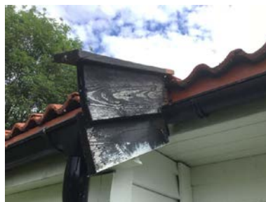
Takrenne mangler endelokk.
