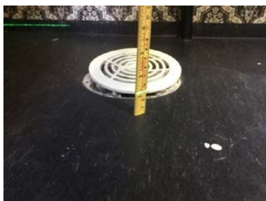
Motfall mot dør er registrert.
