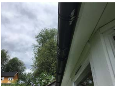
Lekkasje på takrenne.
