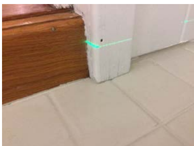
Fuktopptrekk i omramning til dør.
