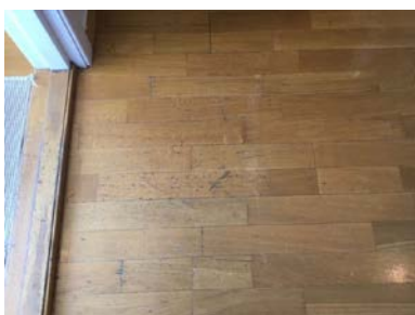
Slitasje på overflater.
