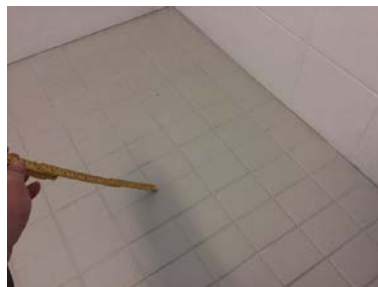
Bom på fliser ved servant.
