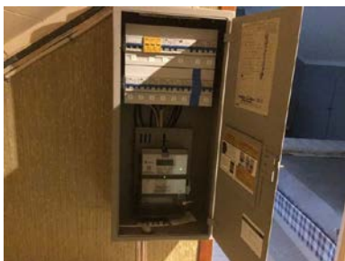
Sikringsskap plassert i loftsetasje.
