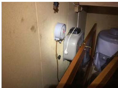
Oljeløfter plassert på bod under trapp.
