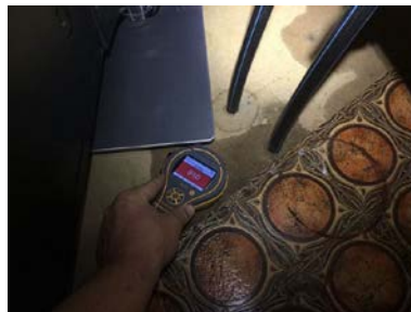
Det ble registrert forhøyet verdi på gulv ved stoppekran. Årsak er trolig kondensering på rør etter at selger hadde benyttet mye vann for å vaske fasade på bolig.
