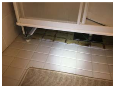
Fliser på gulv er malt, men ikke under dusjkabinett.
