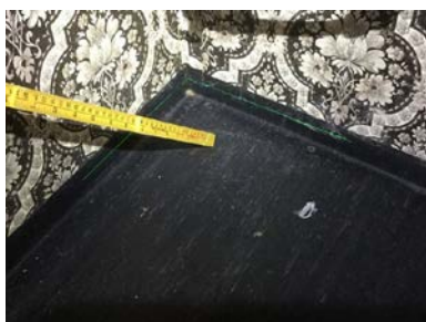
Gulvbelegg har løsnet fra underlag i hjørne.
