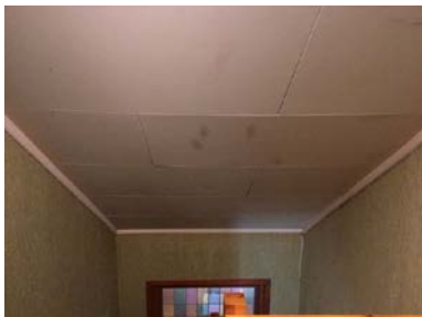
Himling i trapp til loftsetasje "henger" noe.
