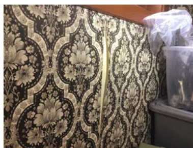
Tapet har løsnet fra underlag.
