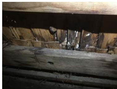
Råteskade på undertak. Denne er trolig gammel og var tørr ved befaring.
