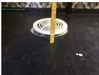
Motfall mot dør er registrert.
