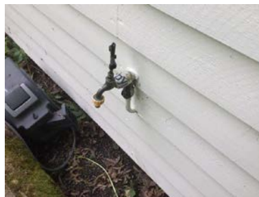
Utekran i dårlig stand.
