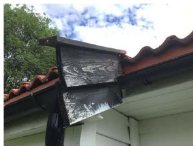
Takrenne mangler endelokk.
