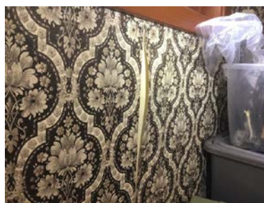
Tapet har løsnet fra underlag.
