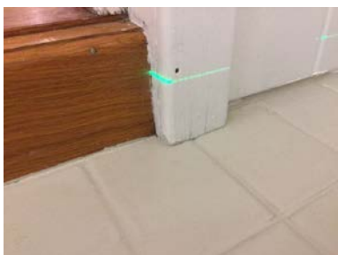
Fuktopptrekk i omramning til dør.
