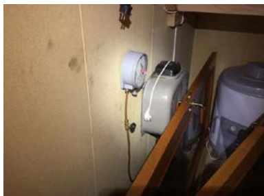
Oljeløfter plassert på bod under trapp.
