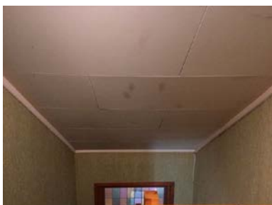
Himling i trapp til loftsetasje "henger" noe.
