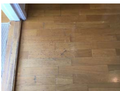
Slitasje på overflater.
