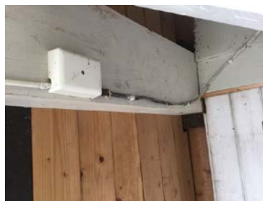
Eldre strømkabler er koblet sammen med nyere anlegg. Ledning mellom koblingspunkt bør byttes.
