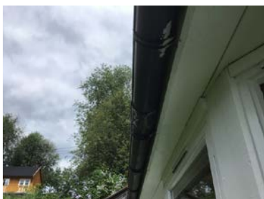
Lekkasje på takrenne.
