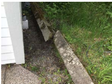
Større sprekker og skjevheter på støttemur.
