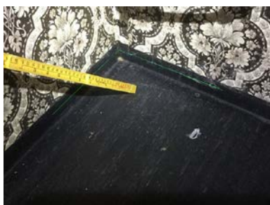
Gulvbelegg har løsnet fra underlag i hjørne.
