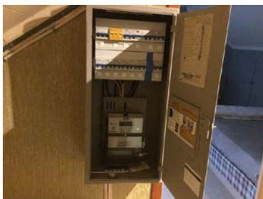
Sikringsskap plassert i loftsetasje.
