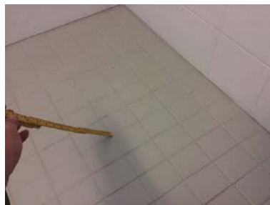
Bom på fliser ved servant.
