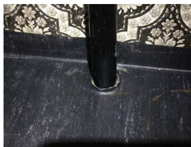
Utettheter rundt rørføringer.
