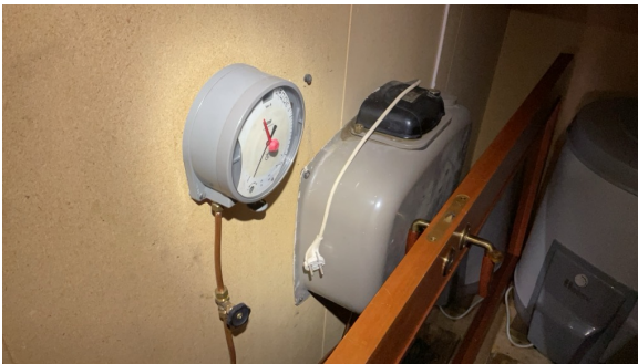
Oljeløfter plassert på bod under trapp.
