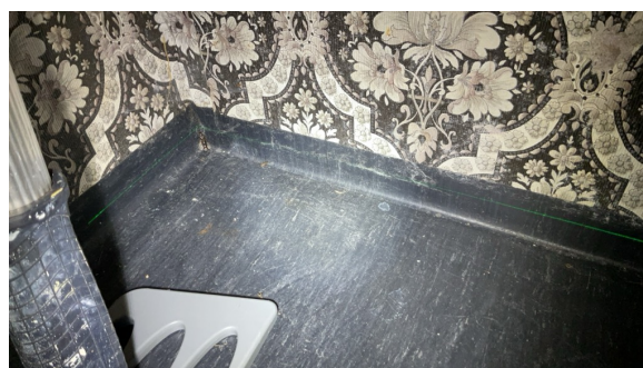
Gulvbelegg har løsnet fra underlag i hjørne.
