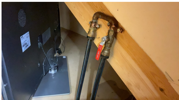
Stoppekran plassert på bod under trapp.
