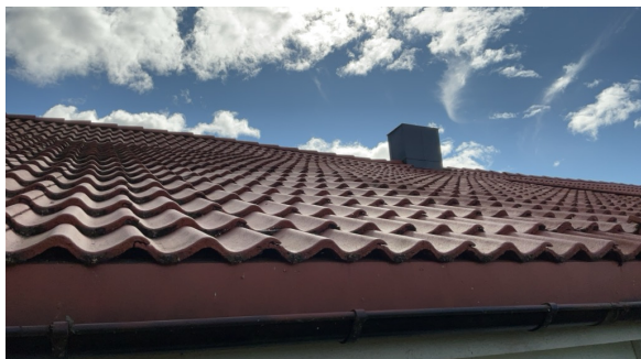
Noe skjevheter i konstruksjon.
