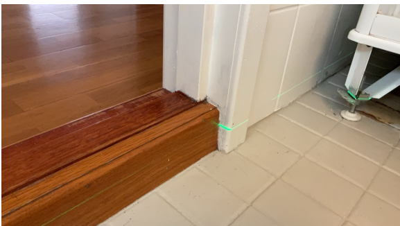
Fuktopptrekk i omramning til dør.
