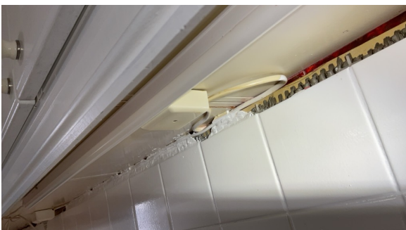
Manglende festing av ledning på kjøkken.
