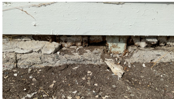
Råteskader på vegg mot sør.
