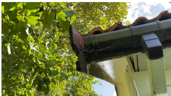
Råteskader på vindskier.
