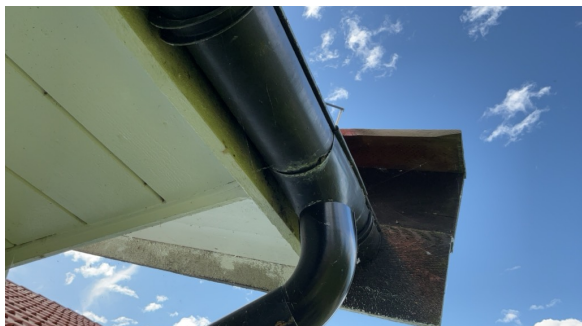
Lekkasje på takrenne.
