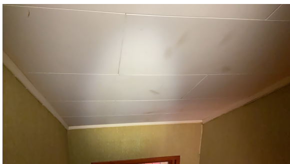
Himling i trapp til loftsetasje "henger" noe.
