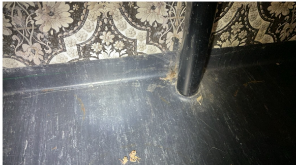
Utettheter rundt rørføringer.
