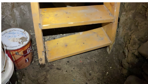
Råteskader på trapp.
