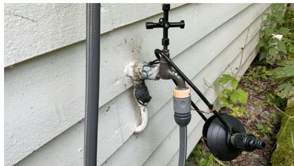
Utekran i dårlig stand.
