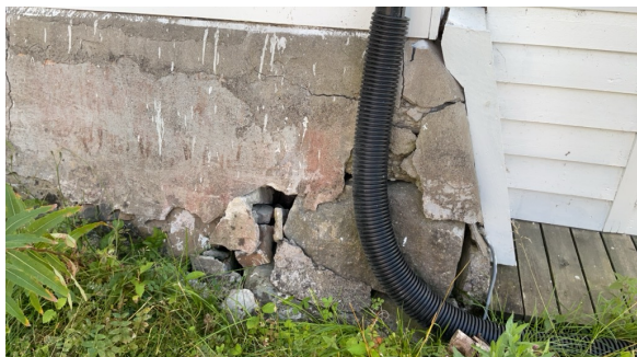
Sprekker i grunnmur.
