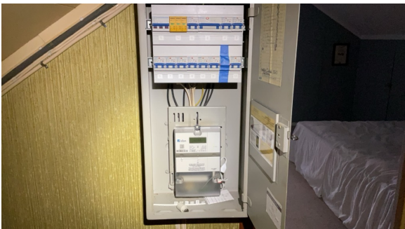
Sikringsskap plassert i loftsetasje.
