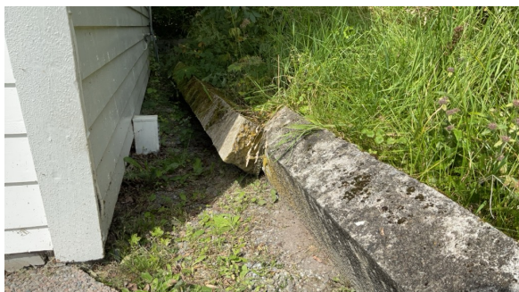
Større sprekker og skjevheter på støttemur.
