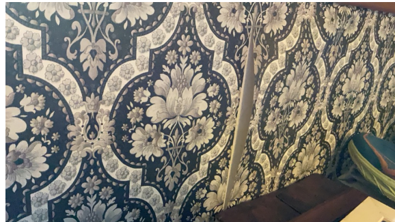
Tapet løsner på vegg.
