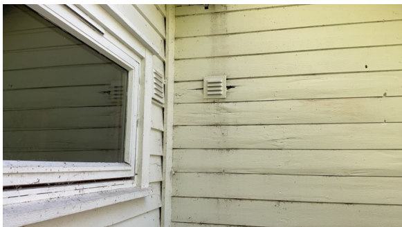
Råteskader på veggkonstruksjon, tilbygg mot nord på bolig.
