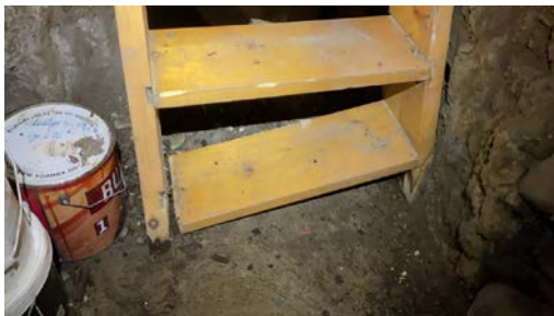
Råteskader på trapp.
