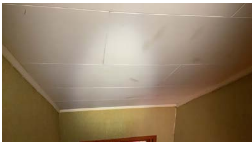
Himling i trapp til loftsetasje "henger" noe.
