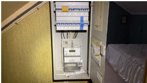
Sikringsskap plassert i loftsetasje.
