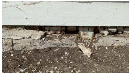
Råteskader på vegg mot sør.
