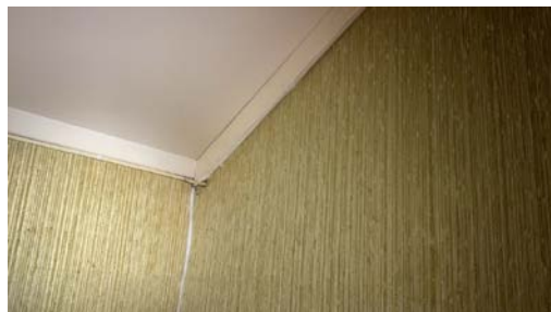
Rennemerker på vegg i trapp.
