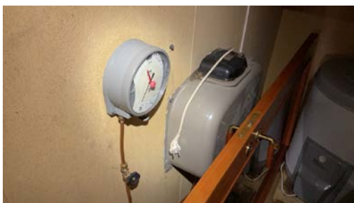
Oljeløfter plassert på bod under trapp.
