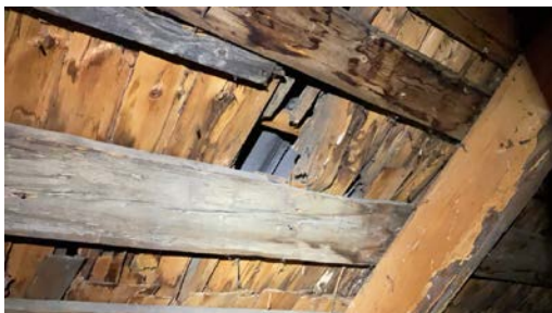
Hull i undertak.
