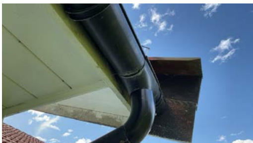
Lekkasje på takrenne.
