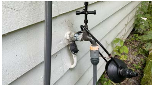
Utekran i dårlig stand.
