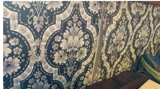
Tapet løsner på vegg.
