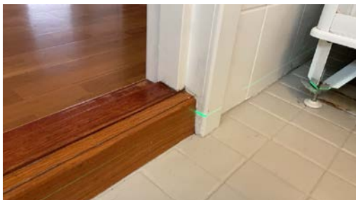
Fuktopptrekk i omramning til dør.
