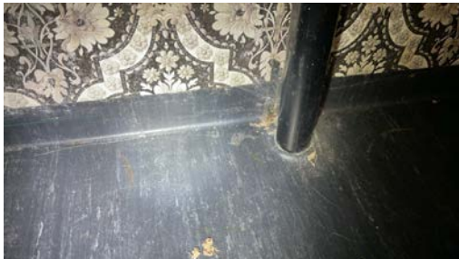
Utettheter rundt rørføringer.
