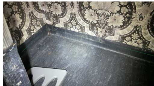
Gulvbelegg har løsnet fra underlag i hjørne.
