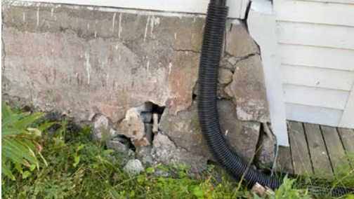
Sprekker i grunnmur.
