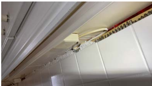
Manglende festing av ledning på kjøkken.
