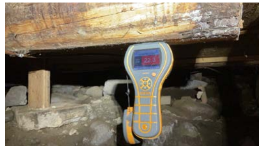
Ved fuktmåling målte jeg skadelig fukt, dette tilsier at konstruksjonen er utsatt for fuktpåkjenning.
