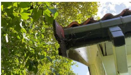
Råteskader på vindskier.
