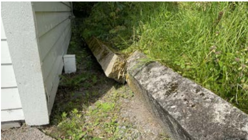
Større sprekker og skjevheter på støttemur.
