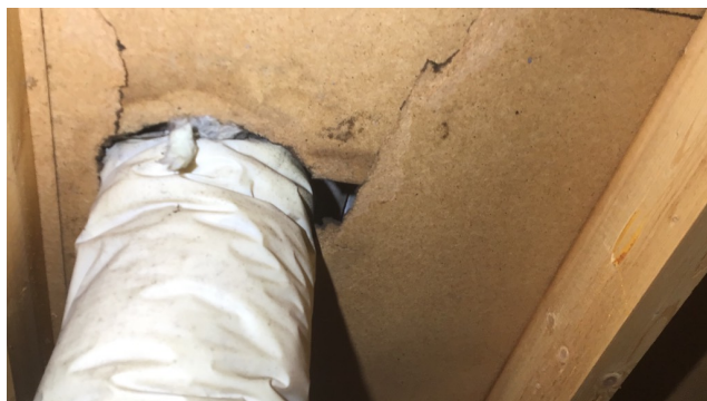
Utettheter rundt gjennomføring i undertak
