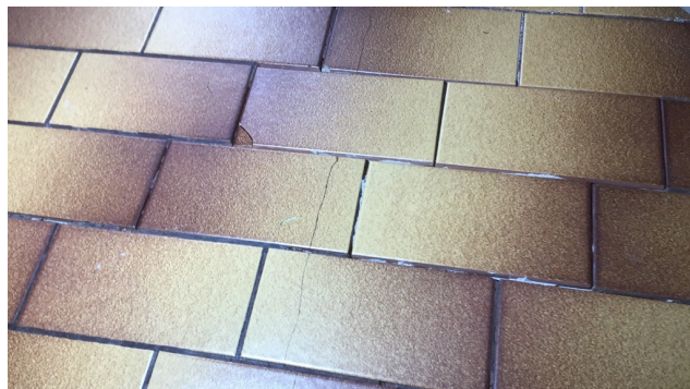
Knekte/sprekke fliser i gang
