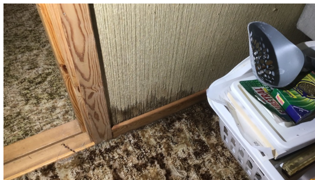
Fukt skade nedkant vegg
