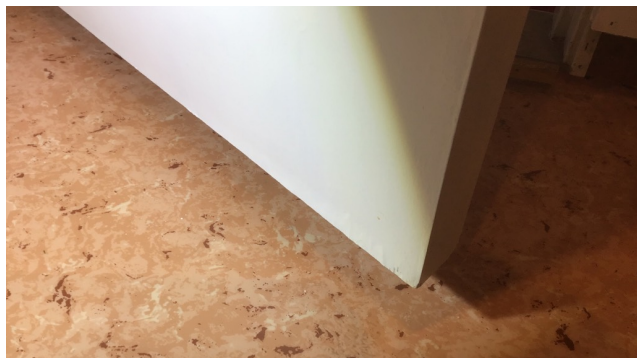
Fukt skader i nedkant badedør
