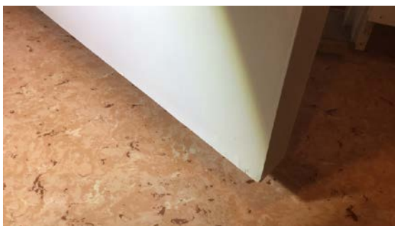
Fukt skader i nedkant badedør
