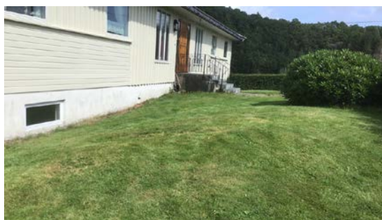
Fall mot grunnmur
