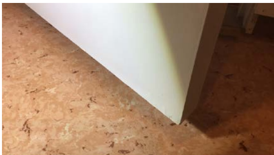
Fukt skader i nedkant badedør
