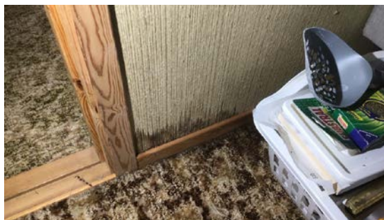
Fukt skade nedkant vegg
