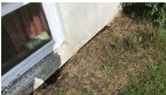
Grunnmurs plast synlig på begrenset område
