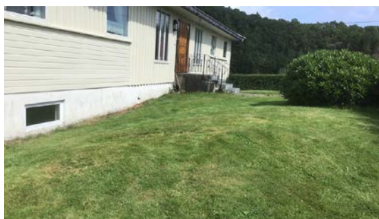
Fall mot grunnmur
