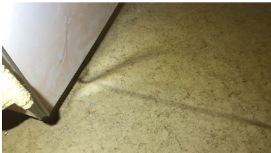
Belegg buler opp fra gulv
