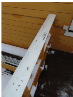
Malingsavflassing/fuktskader i håndløper.
