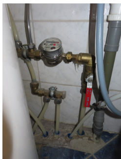
Hovedstoppekran og vannmåler.
