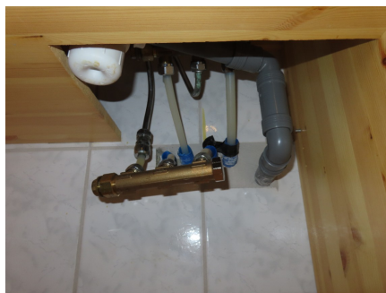
Samlestokker inne i servantskap. Ufagmessig utførelse.
