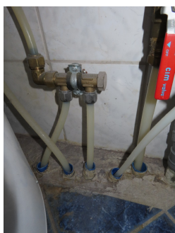
Rørføringer åpen etablert med vararør uten mansjetter. Ufagmessig utførelse.
