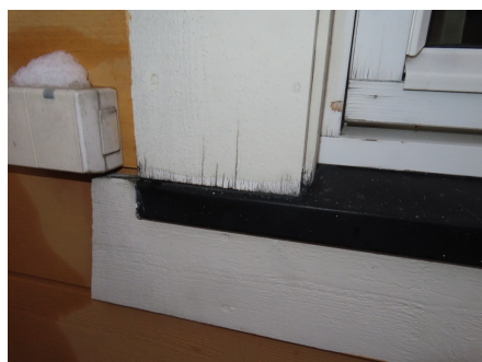
Fuktopptrekk i endeved på sideomramming.
