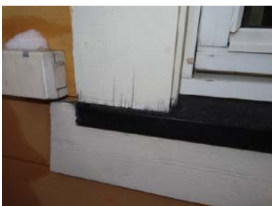
Fuktopptrekk i endeved på sideomramming.
