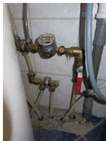
Hovedstoppekran og vannmåler.
