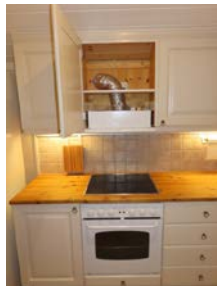
Kokeskone med avtrekksventilator og avtrekk ført ut gjennom vegg med utvendig blafreventil.
