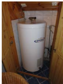
200 liters bereder fra bygge/renoveringsår.
