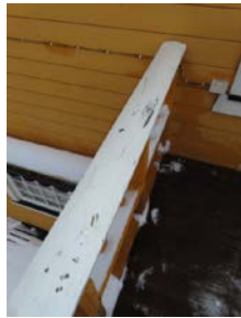
Malingsavflassing/fuktskader i håndløper.
