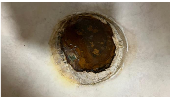
Feil utførelse av belegg i sluket
