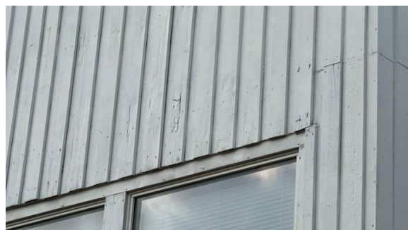
Eksempel på spredt råteskade i kledningen
