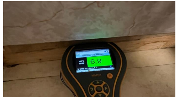
Fuktmåling i svill ved dusjkabinettet
