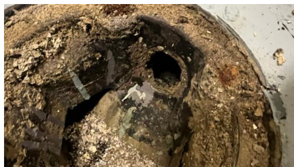
Sluket på vaskerommet mangler tropp.
