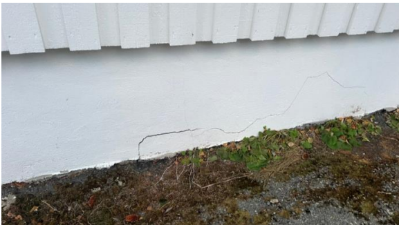
Sprekk i grunnmuren fra utsiden som indikerer skade som følge av jordtrykk.
