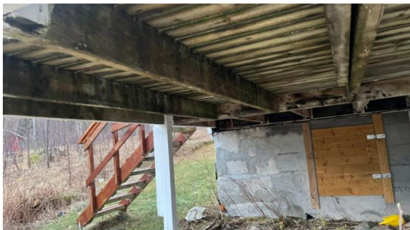
Eksempel på skader på verandaen
