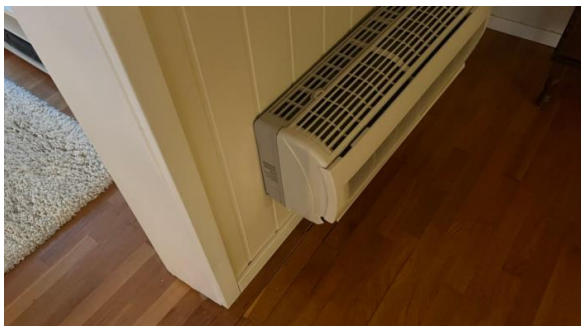
Skader i parketten
