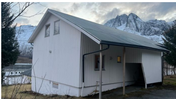
Eksempel på manglende snøfangere
