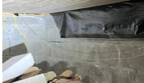
Eksempel på sprekk i grunnmuren som er tegn på jordtrykk
