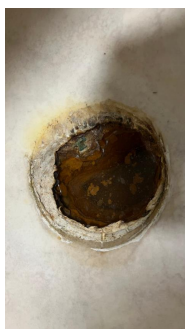
Rust i jernsluket på badet i 1. etasje
