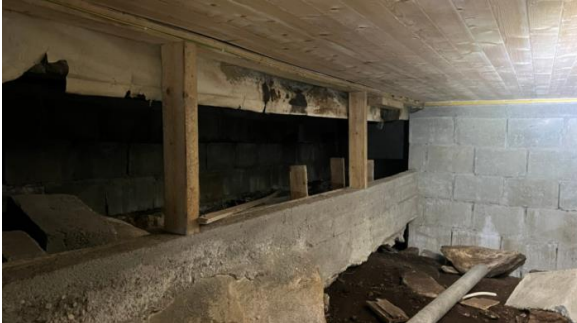
Manglende fundamentering til grunnen under sålen/betongfundamentet.
