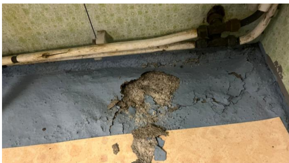
Fuktopptak gjennom gulvet fører til at overflatebehandlingen på gulvet løsner.
