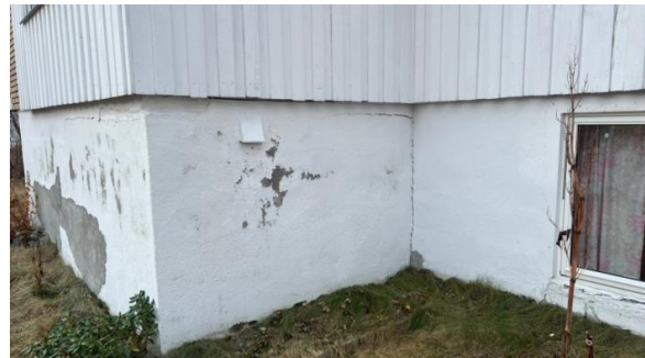
Eksempel på sprekk i grunnmuren som er indikasjon på setning/bevegelse i grunnen.
