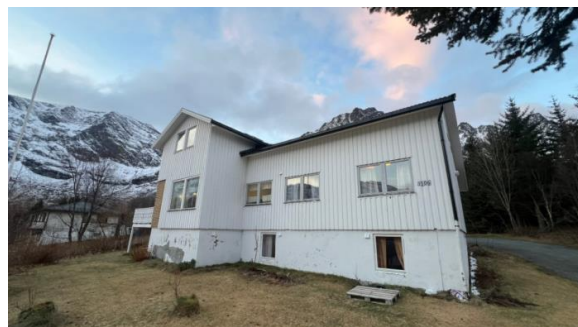
Eksempel på manglende snøfangere
