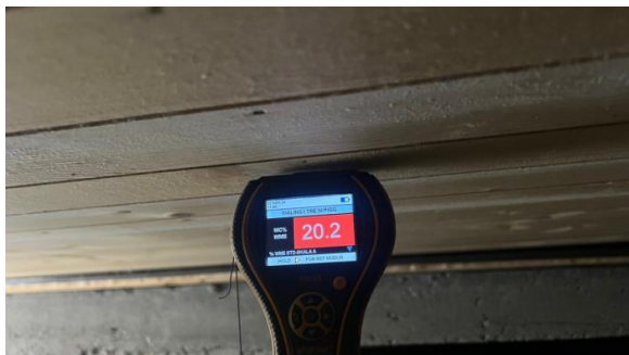
Fuktmåling i treverk i krypekjelleren viser skadelige fuktverdier
