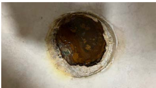
Feil utførelse av belegg i sluket
