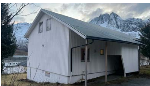
Eksempel på manglende snøfangere
