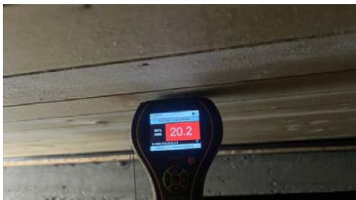
Fuktmåling i treverk i krypekjelleren viser skadelige fuktverdier
