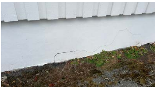
Sprekk i grunnmuren fra utsiden som indikerer skade som følge av jordtrykk.
