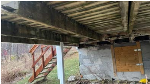
Eksempel på skader på verandaen
