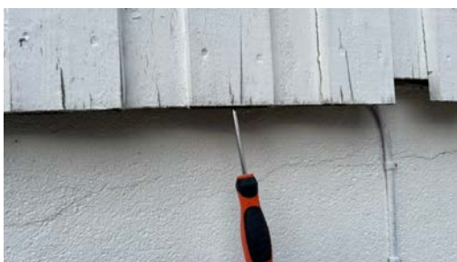
Eksempel på spredt råteskade i kledningen
