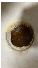
Rust i jernsluket på badet i 1. etasje
