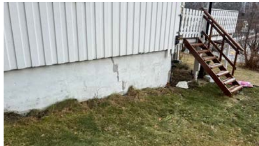
Manglende rekkverk på trappen.
