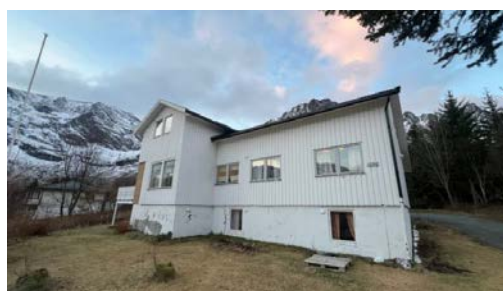
Eksempel på manglende snøfangere
