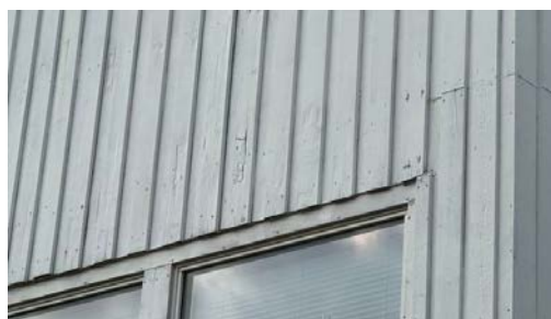
Eksempel på spredt råteskade i kledningen
