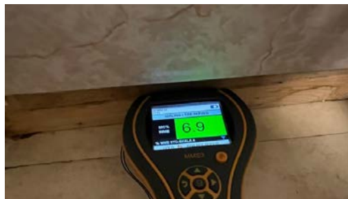
Fuktmåling i svill ved dusjkabinettet
