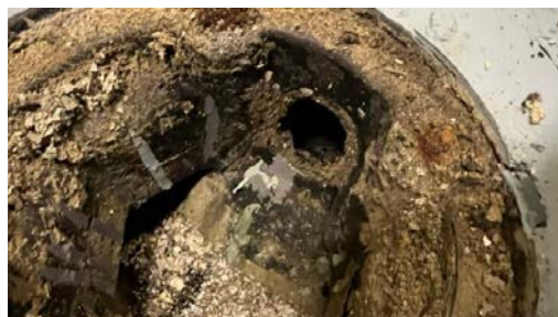
Sluket på vaskerommet mangler tropp.
