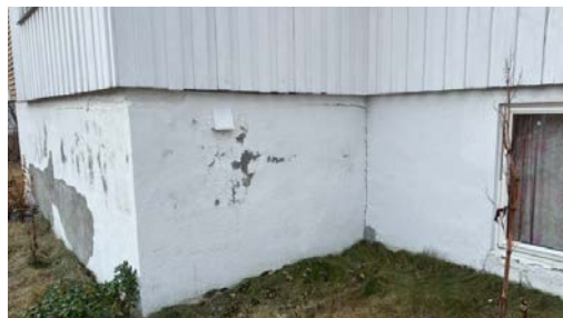
Eksempel på sprekk i grunnmuren som er indikasjon på setning/bevegelse i grunnen.
