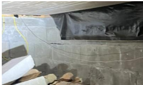
Eksempel på sprekk i grunnmuren som er tegn på jordtrykk
