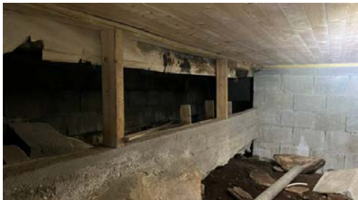
Manglende fundamentering til grunnen under sålen/betongfundamenter.
