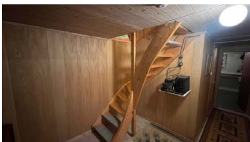
Kjellertrapp uten rekkverk
