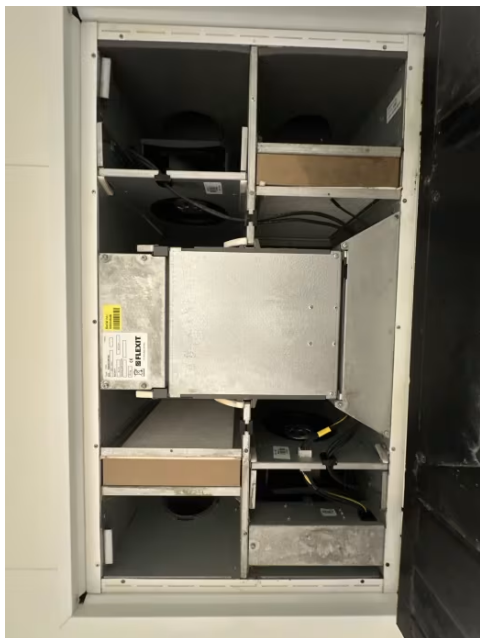
Viser innvendig i ventilasjonsaggregat.
