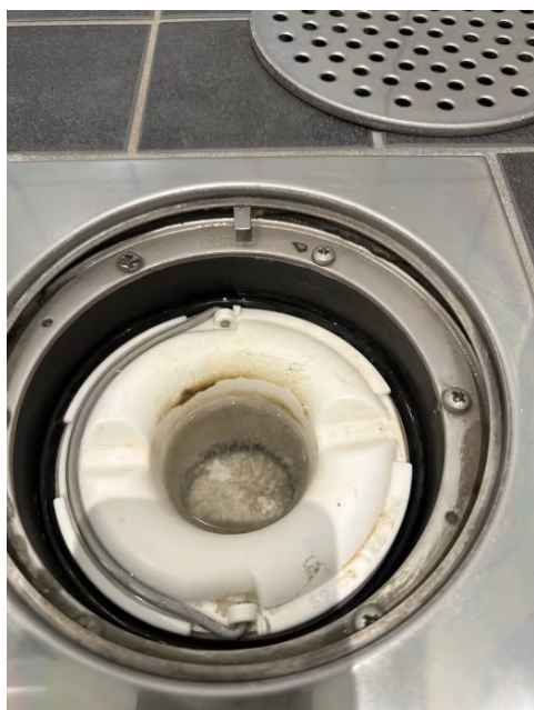
Viser sluk i dusjsonen.
