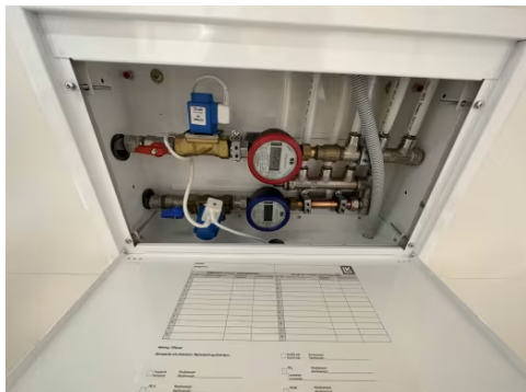
Viser fordelerskap for varme montert i himling på bad.
