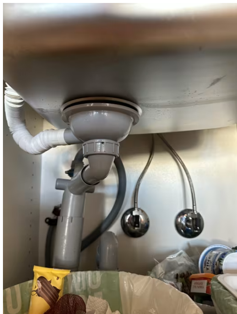
Viser vann og avløpsinnstallasjoner under kum.
