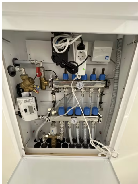
Vannrør med rør i rør system fra fordelerskap plassert i himling på bad og frem til sanitærinstallasjoner på baderom og kjøkken.
