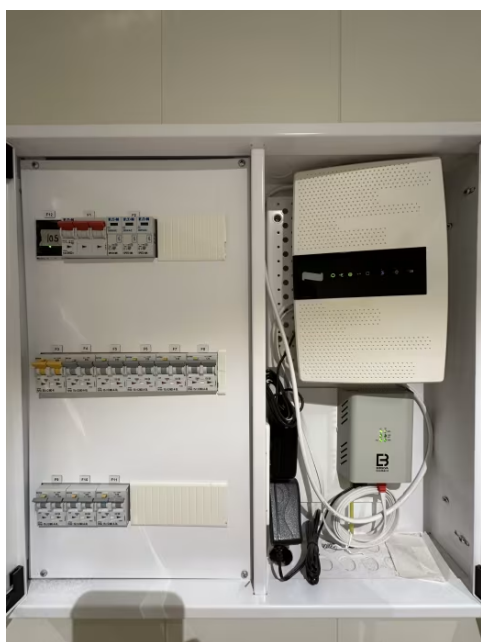
Viser innfelt sikringsskap plassert i gang.
