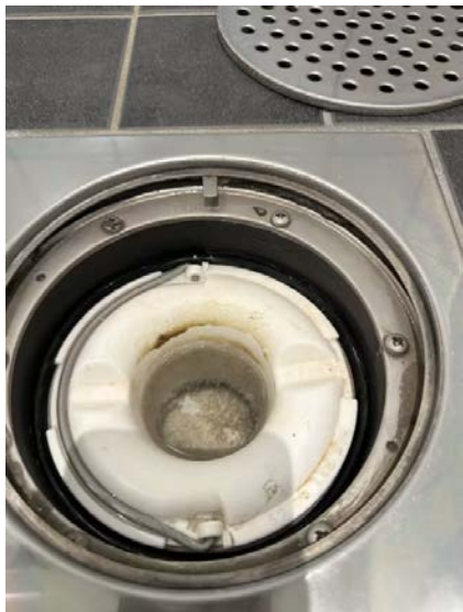
Viser sluk i dusjsonen.
