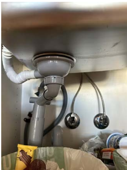
Viser vann og avløpsinnstallasjoner under kum.
