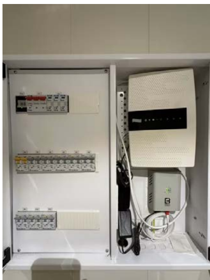
Viser innfelt sikringsskap plassert i gang.
