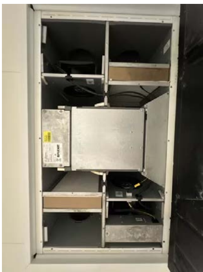
Viser innvendig i ventilasjonsaggregat.
