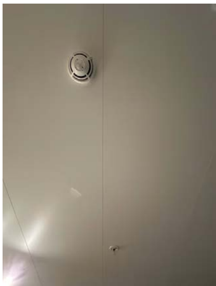
Viser brannvarsling og sprinkel i tak.
