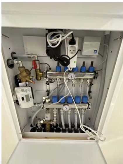
Vannrør med rør i rør system fra fordelerskap plassert i himling på bad og frem til sanitærinstallasjoner på baderom og kjøkken.
