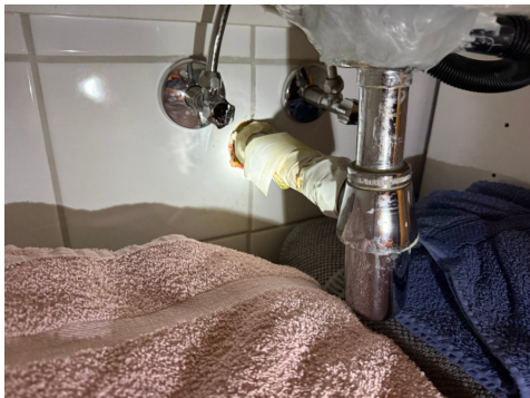
Tape rundt avløpsrør under vask.
