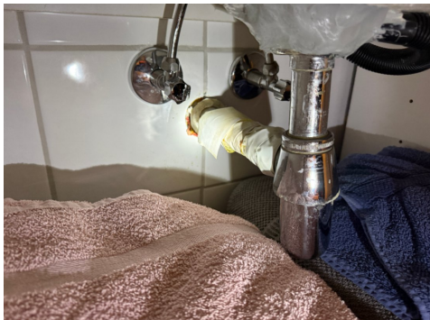
Tape rundt avløpsrør under vask.
