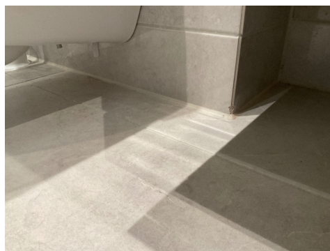
Mindre hakk i flis utv. hjørne i bunn av toalett kasse.
