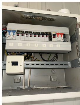
Sikringsskap med automatsikringer.
