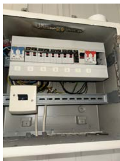
Sikringsskap med automatsikringer.
