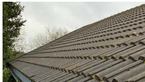
Det er synlig noe nedbøying av yttre del av taket i dette området.
