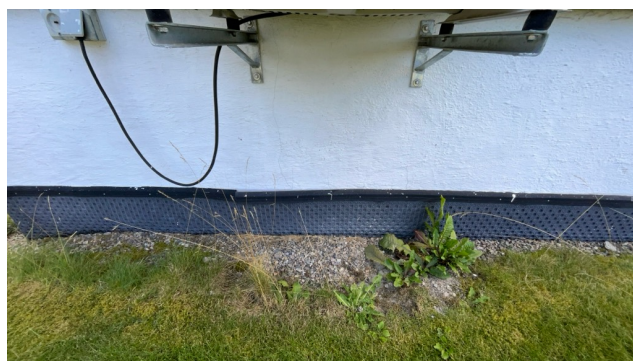
Stedvis behov for lokale utbedringer.
