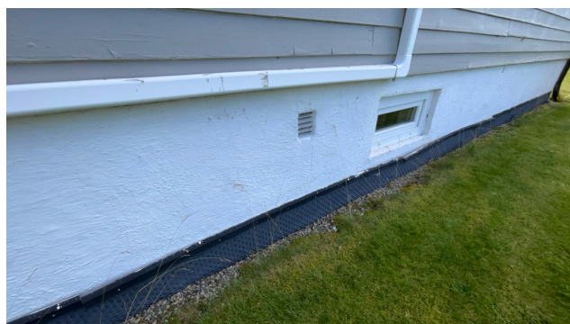
Stedvis behov for lokale utbedringer.
