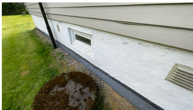
Fuging og utbedringer av beslag må utføres.
