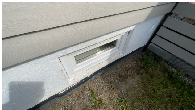
Fuging og utbedringer av beslag må utføres.
