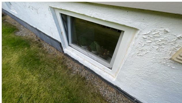
Fuging og utbedringer av beslag må utføres.
