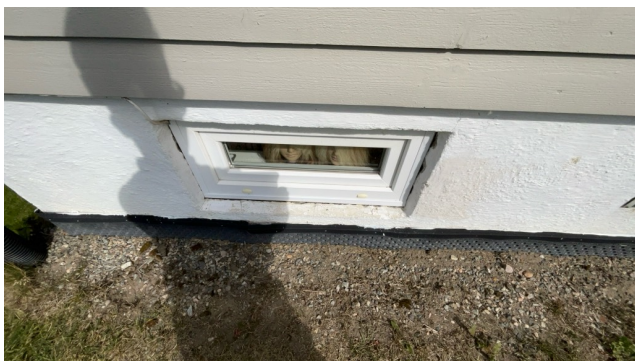
Fuging og utbedringer av beslag må utføres.
