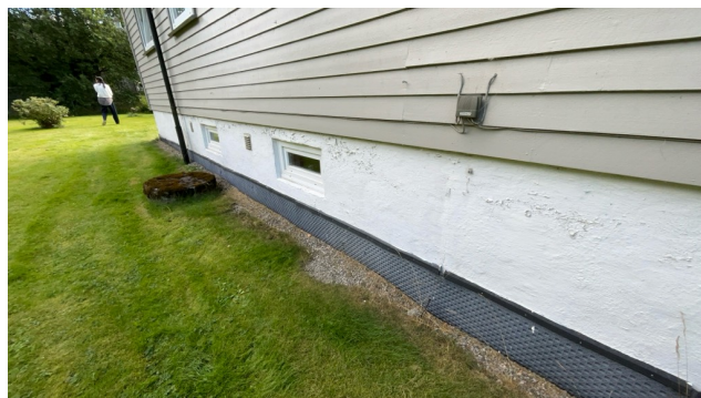
Stedvis behov for lokale utbedringer.
