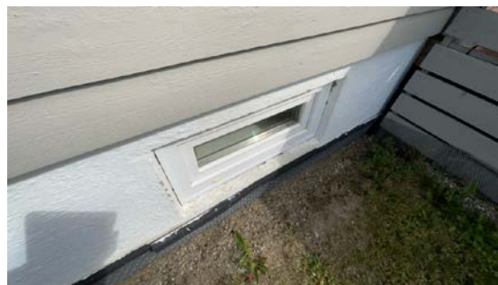
Fuging og utbedringer av beslag må utføres.
