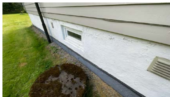
Fuging og utbedringer av beslag må utføres.
