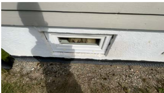
Fuging og utbedringer av beslag må utføres.
