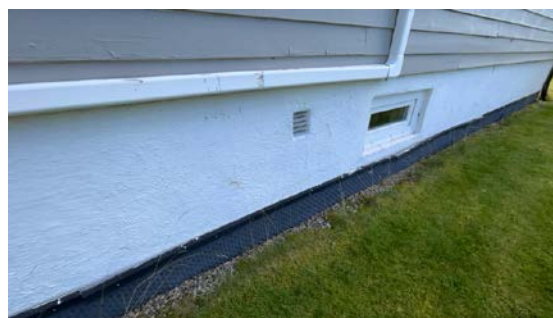
Stedvis behov for lokale utbedringer.
