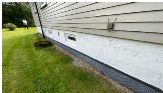
Stedvis behov for lokale utbedringer.
