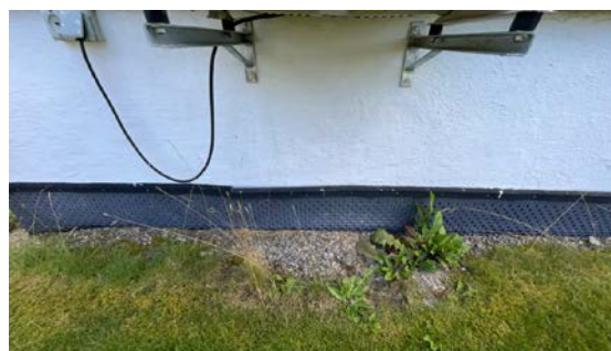
Stedvis behov for lokale utbedringer.
