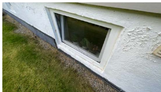
Fuging og utbedringer av beslag må utføres.
