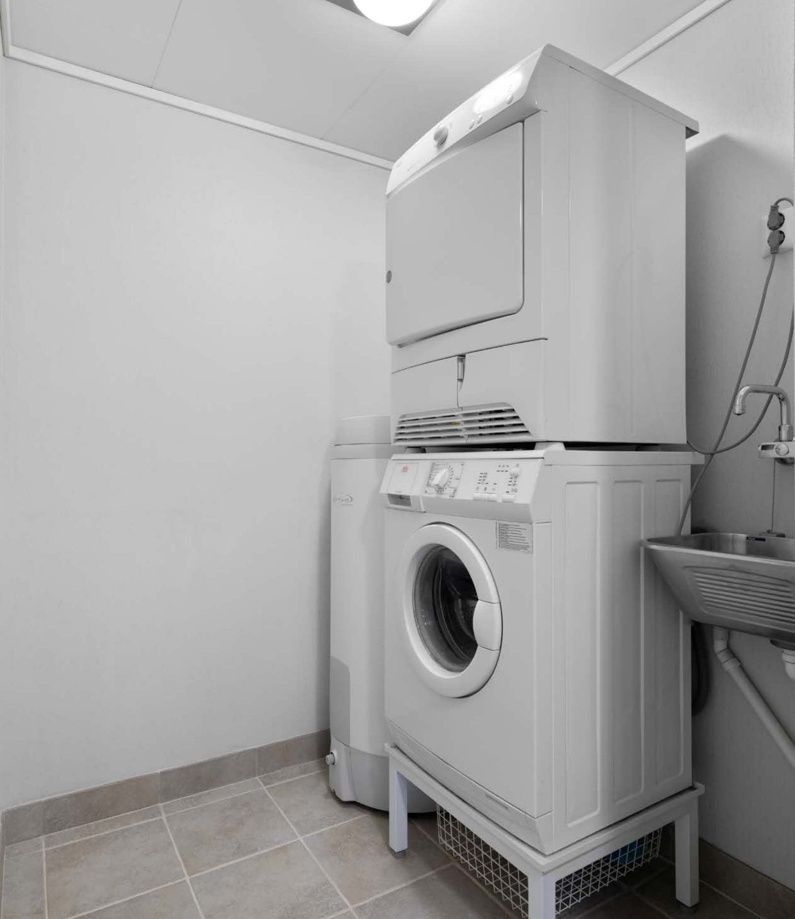
Vaskeromsdel på bad med varmtvannsbereder, utslagsvask og opplegg for vaskemaskin/tørketrommel.
