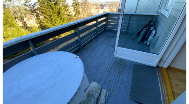
Det er værslitt/oppsprukket trevirke/trepaneler.
