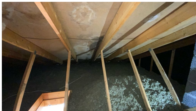
Det er påvist fuktskjolder i undertak/takkonstruksjon.
